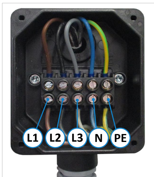
Figur 14: Anslutningar i kopplingslådan
