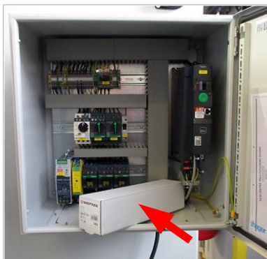
1. La colonne de signalisation et les vis de montage se trouvent dans l'armoire électrique.
